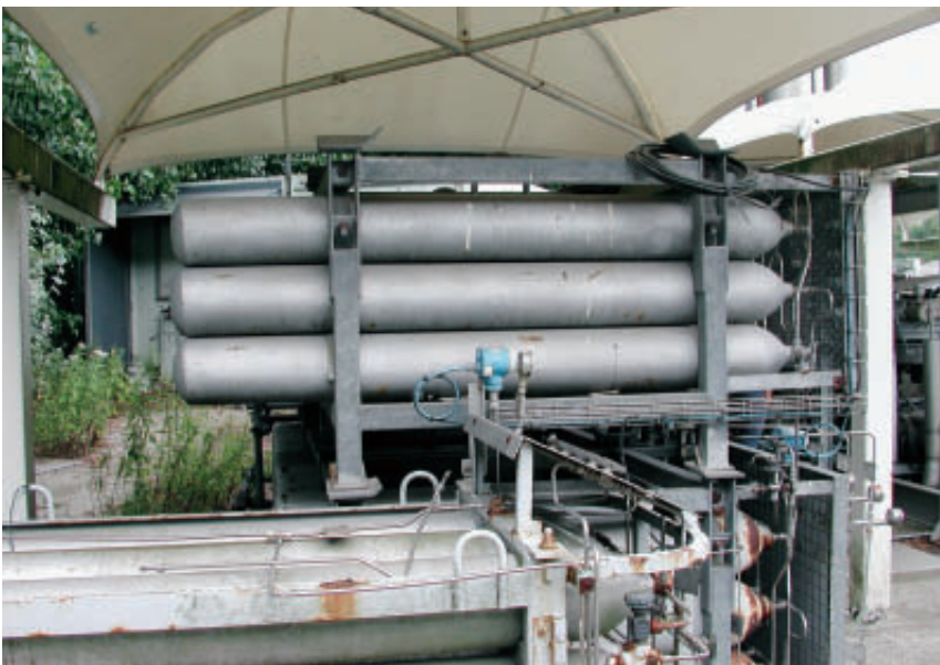
Abb. 7: Hochdrucklager der Biogasaufbereitungsanlage „Marquette“/Lille
